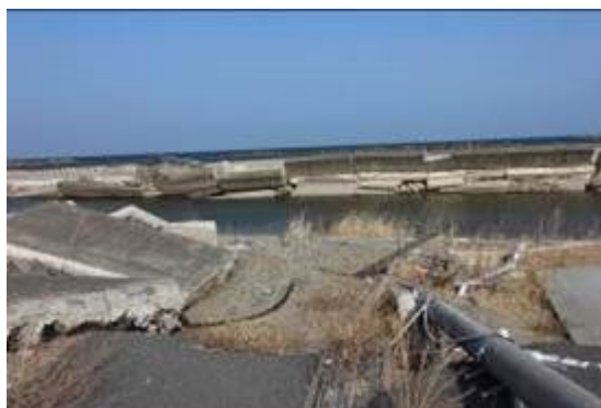
防波堤は壊れたまま
